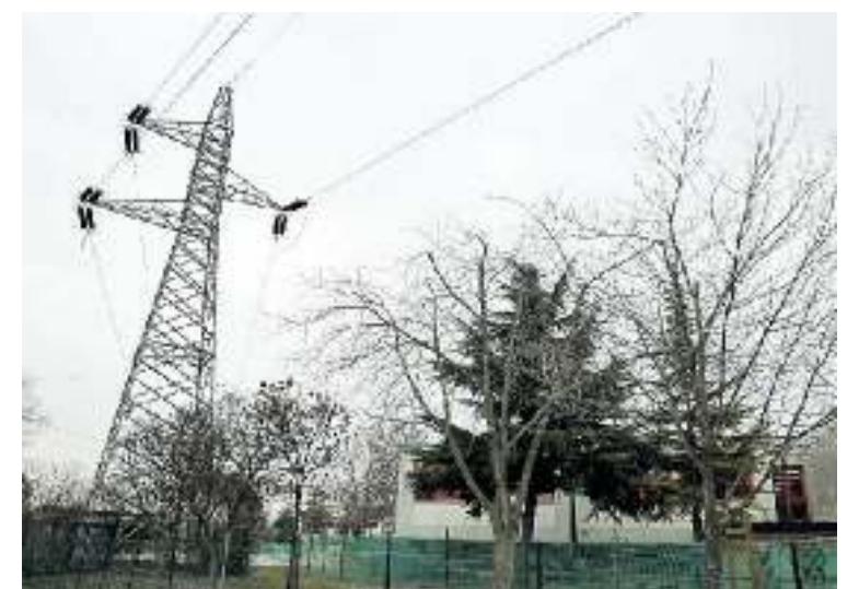
ALTA TENSIONE Il traliccio dell'elettrodoto in via Magellano
