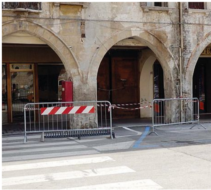
Le transenne in corso Martiri dopo la caduta di calcinacci (foto Gavagnin)
