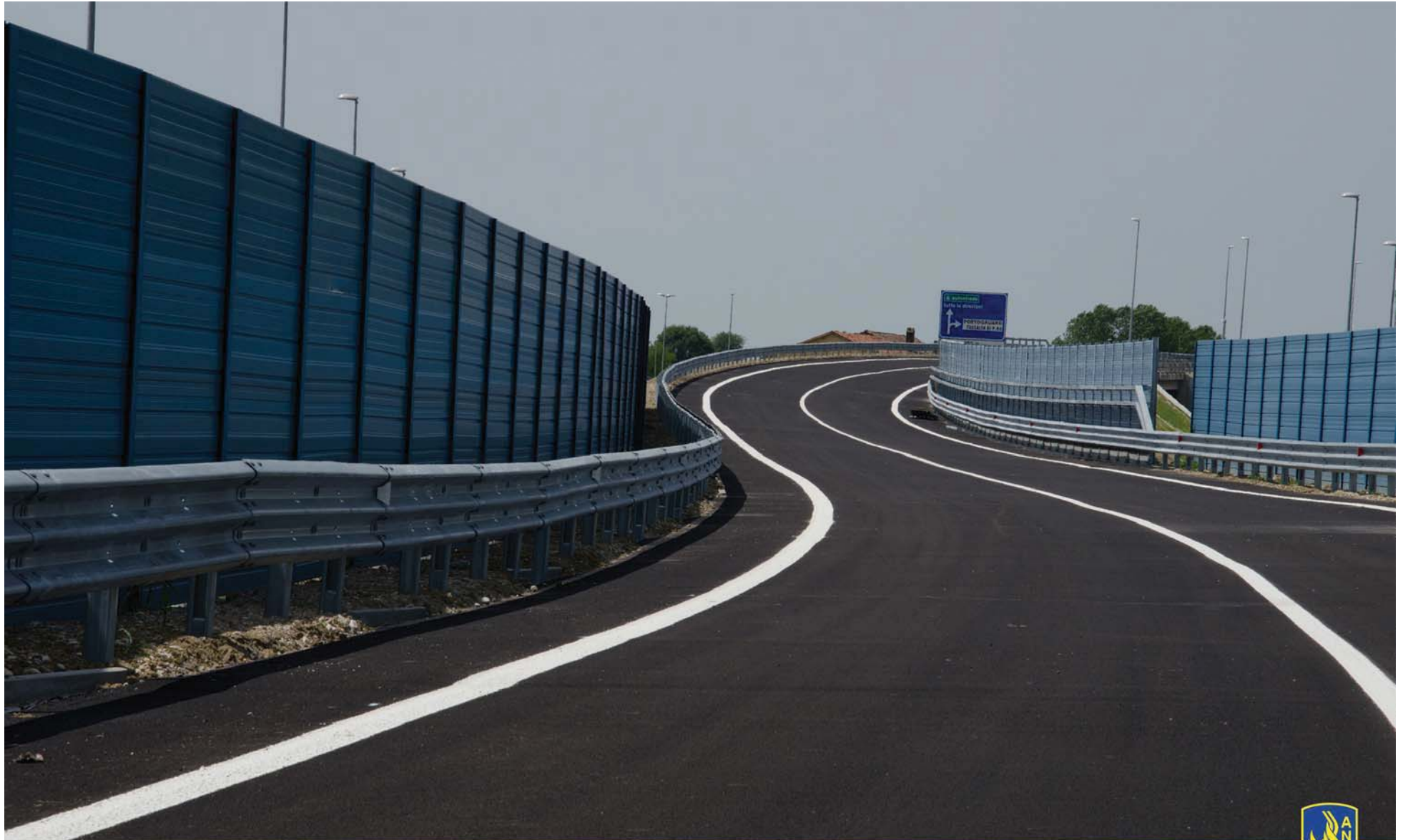
Strada statale 14 "della Venezia Giulia" - IV lotto della variante di Portogruaro, raccordo con la strada statale 14
