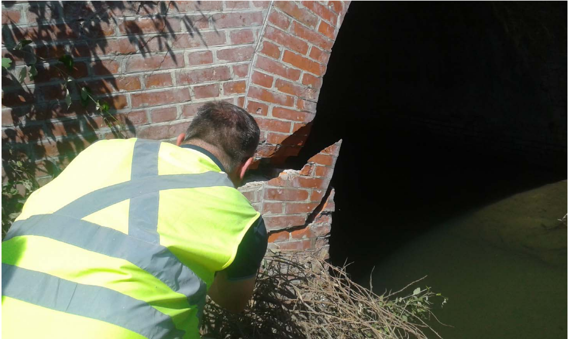
Annone Veneto, ponte in cedimento sul canale Vat Limidot che si trova sulla Postumia (SR53)
