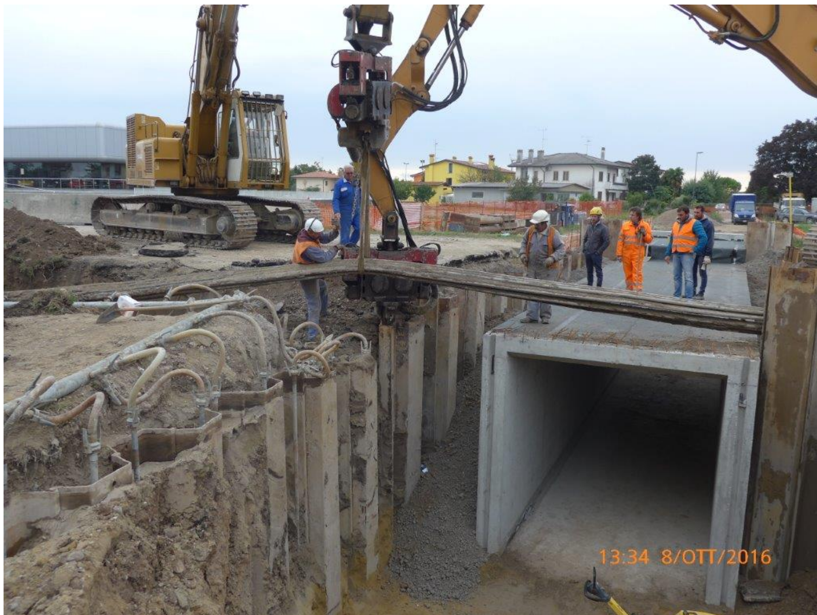
Fossalta di Portogruaro - Lavori al Sottopasso ciclopedonale sulla SS14 tra Via Nobel e Via Pascoli
