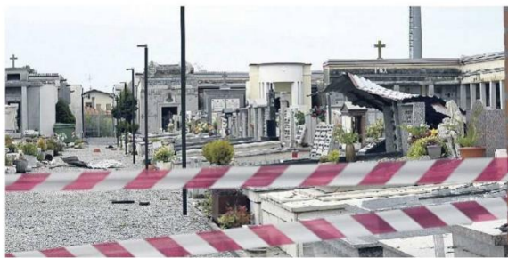
MALTEMPO Danni anche al cimitero, nelle coperture di alcuni edifici
