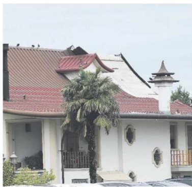
DANNI ALLE ABITAZIONI Il tetto di una casa senza tegole
