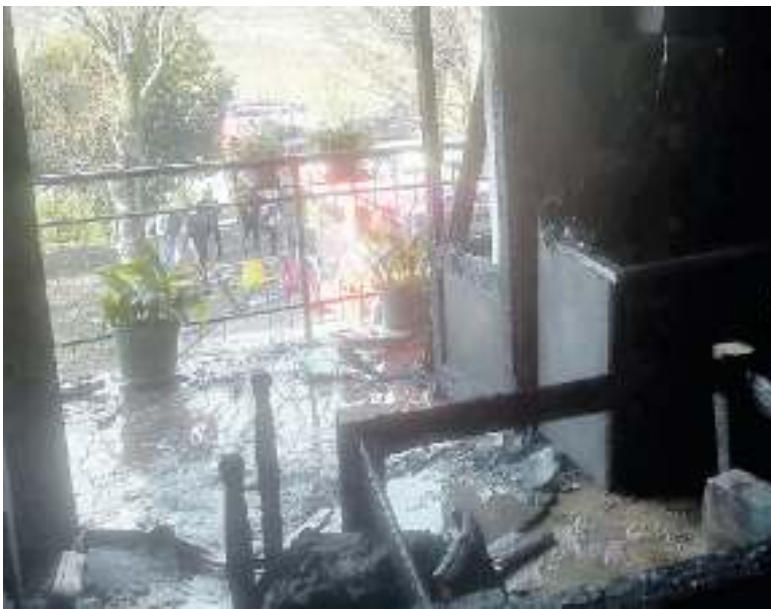
INCENDIO L'interno della cucina distrutta dalle fiamme
