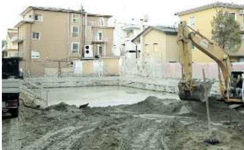
DODICI ANNI FA Il cantiere nel quale avvenne il crollo nel 2008
