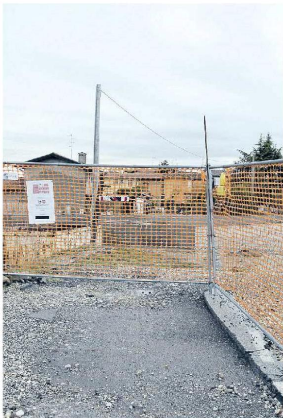
CANTIERE Lavori ancora in corso per il sottopasso ferroviario che collegherà Summaga a Portogruaro
