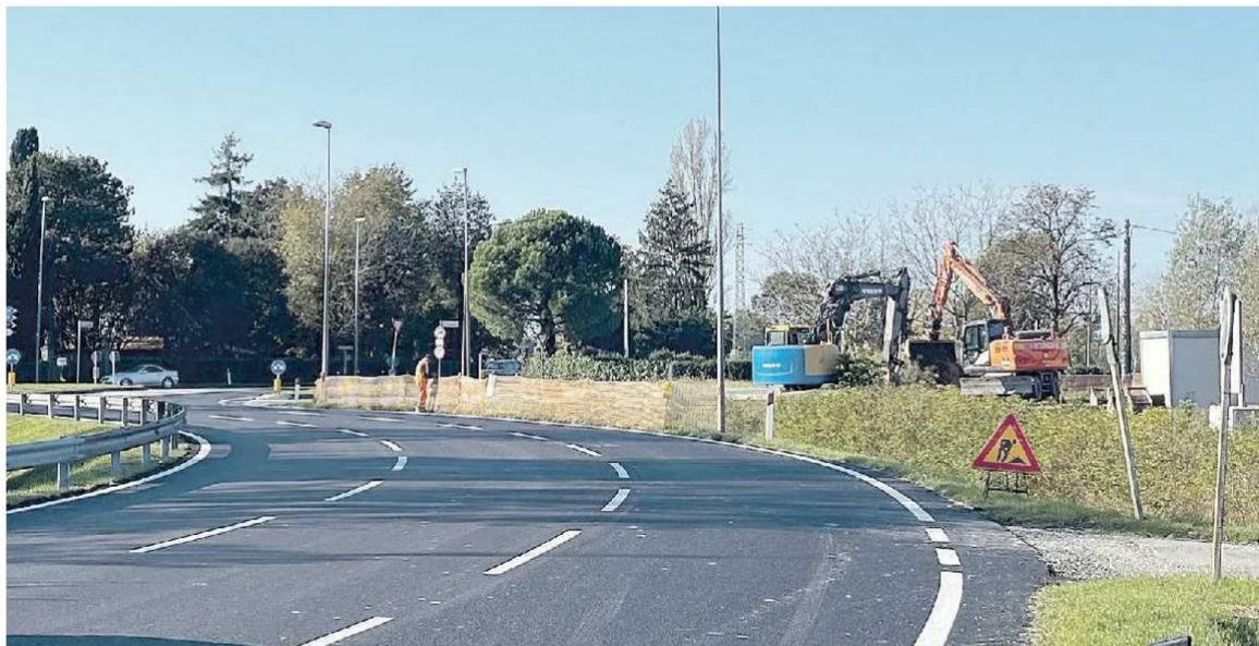
CANTIERI AL LAVORO Dopo quasi un anno sono ripartiti i lavori per la realizzazione del nuovo innesto sulla Regionale 53. Sopra, il nuovo asilo
