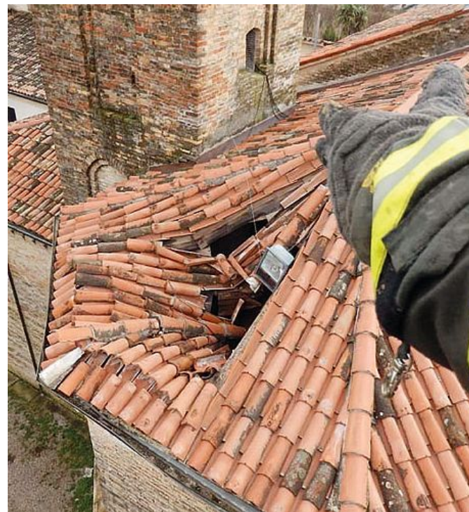
Un vigile del fuoco indica il punto in cui il tetto ha ceduto (Foto Gavagnin)
