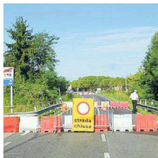
Il ponte chiuso perché pericolante
