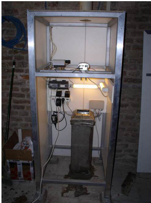
Figura 3.2 Mobile-rack. Visione d'insieme
